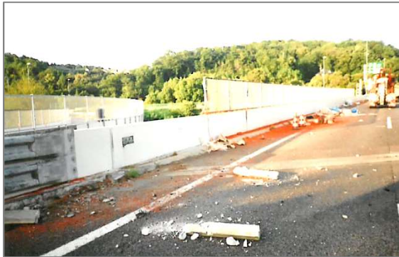
写真 6-1 側壁の損傷状況
